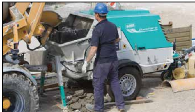
Alimentación para camión, hormigonera o autohormigonera.
