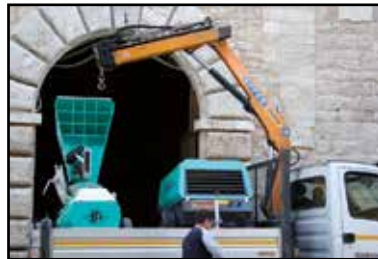
Equipos para bombeo, (transportadora más compresor), sobre un pequeño furgón abierto, que permite fáciles, ágiles y económicos traslados de obra en obra
